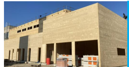
Projet « Nouveau Traitement Thermique » à Amiens
