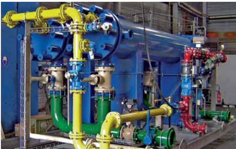
Unité de dilution d'acide sulfurique
